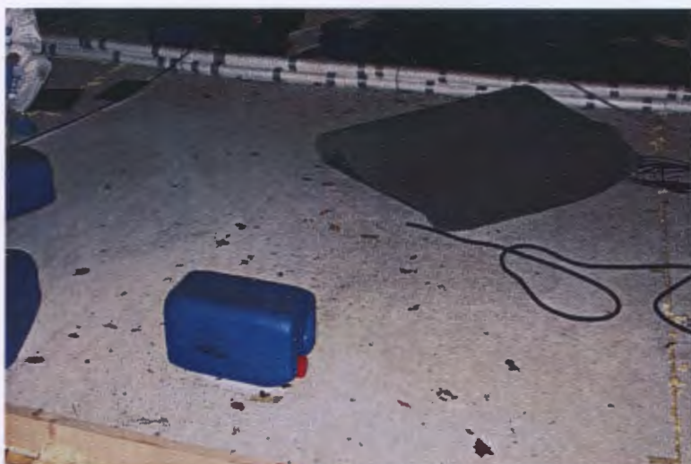
Bilde nr. 15. Bildet viser areal som ikke er støvsuget. De svarte flekkene på gulvet er blader og annet organisk materiale fra vegetasjon som antas å ha kommet inn i lokalene via spaltene på møneveggen.
